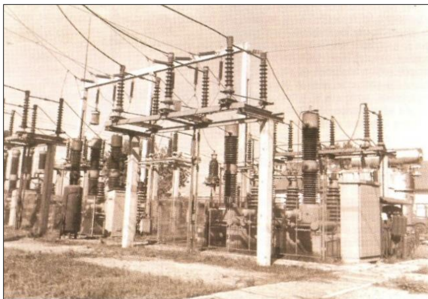
Aspect al Stației de transformare 110 / 35 / 6 KV – Iași Centru, prin care, la 27 dec.1957, Uzina de Lumină a fost racordată la S.E.N.
