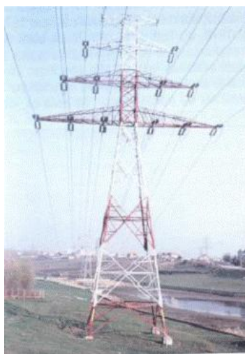
Stâlp metalic de înaltă tensiune cu 4 circuite de 110 KV, o «premieră» pentru soluția alimentării CUG Iași (1981)
