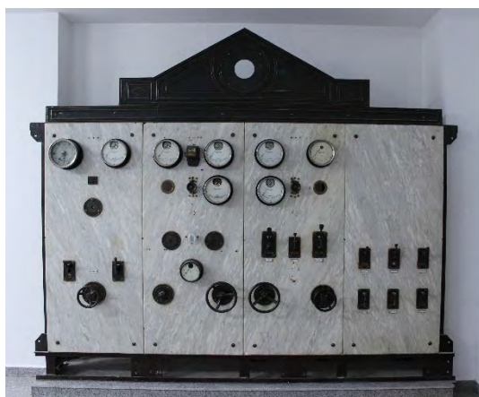
Fig. 7. Panoul de comandă și distribuție al centralei termice inițiale
