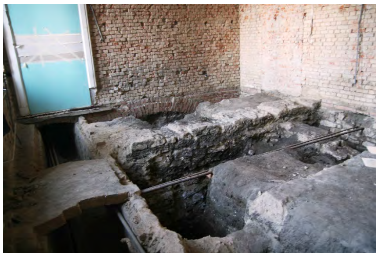
Fig. 17. Aspect general asupra intersecțiilor de zidării, imediat după demontarea pardoselii de parchet, în încăperea P. 90
