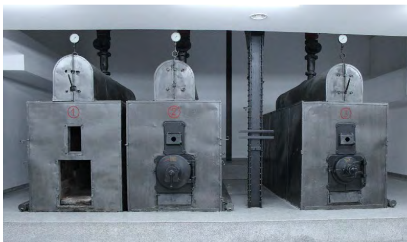
Fig. 5. Cazanele centralei termice inițiale
