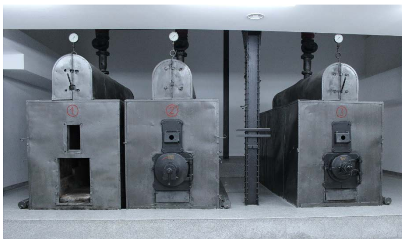
Fig. 5. Cazanele centralei termice inițiale
