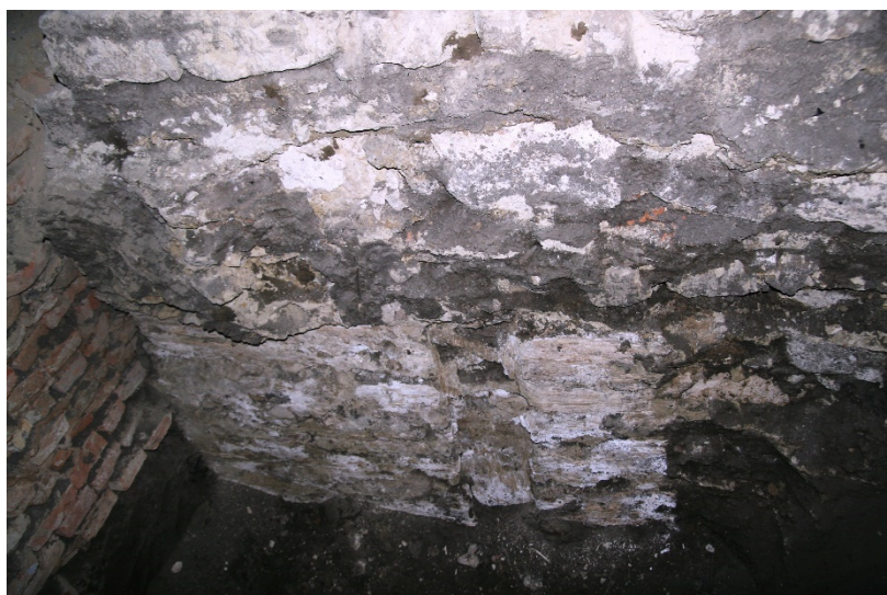
Fig. 27. Traseul canalului instalației termice care sparge zidăria de piatră anterior existentă
