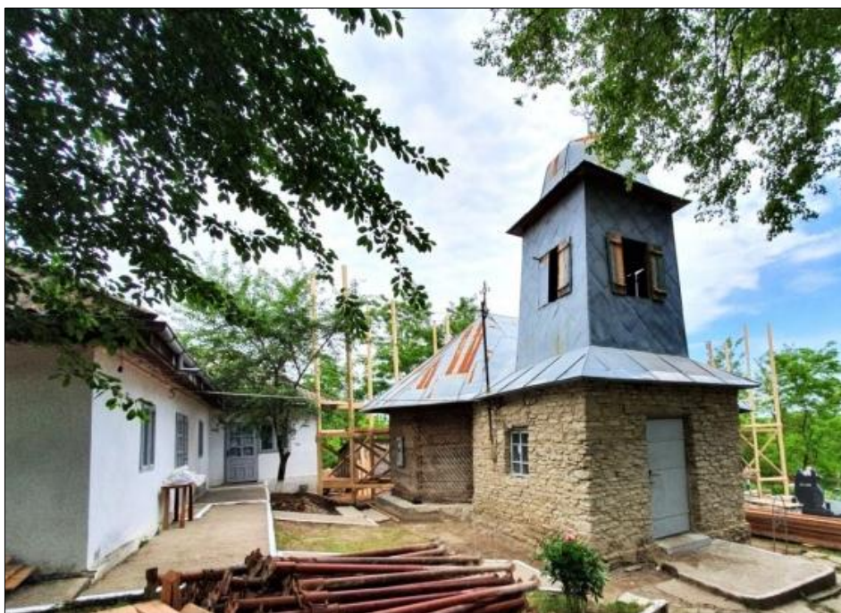
Fig. 13. Biserica „Sf. Treime” din Băiceni, 2020 înainte de „restaurare”, sursa: Ludmila Bacumenco-Pîrnău, Dan Aparaschivei, op. cit. , p. 400.
