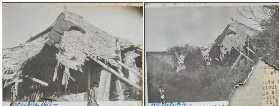
Fig. 12. Ultimele fotografii cunoscute ale bisericii Rufeni, realizate de arh. Stoian în 1951, sursa: INP, Fond CMI , dosar 2004/1918-1951, filele 27-28.
